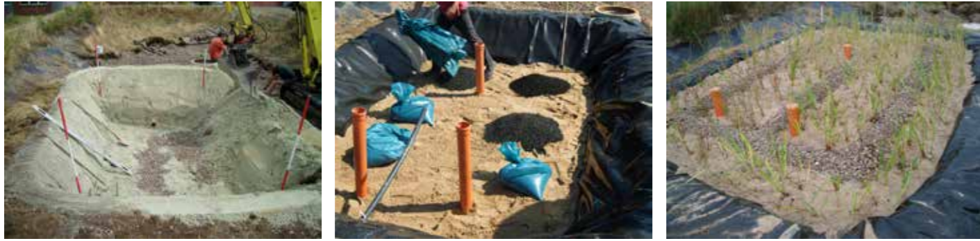
Pflanzenfilter gegen Arzneimittelrückstände: Die Uni Bremen entwickelt ein Verfahren für Kläranlagen, das die Wirkstoffe im Abwasser effektiv und kostengünstig rausholt. Pflanzenkohle hält die Reststoffe beim Durchsickern einfach fest, eine oberste Schicht Grünpflanzen unterstützt dabei.
