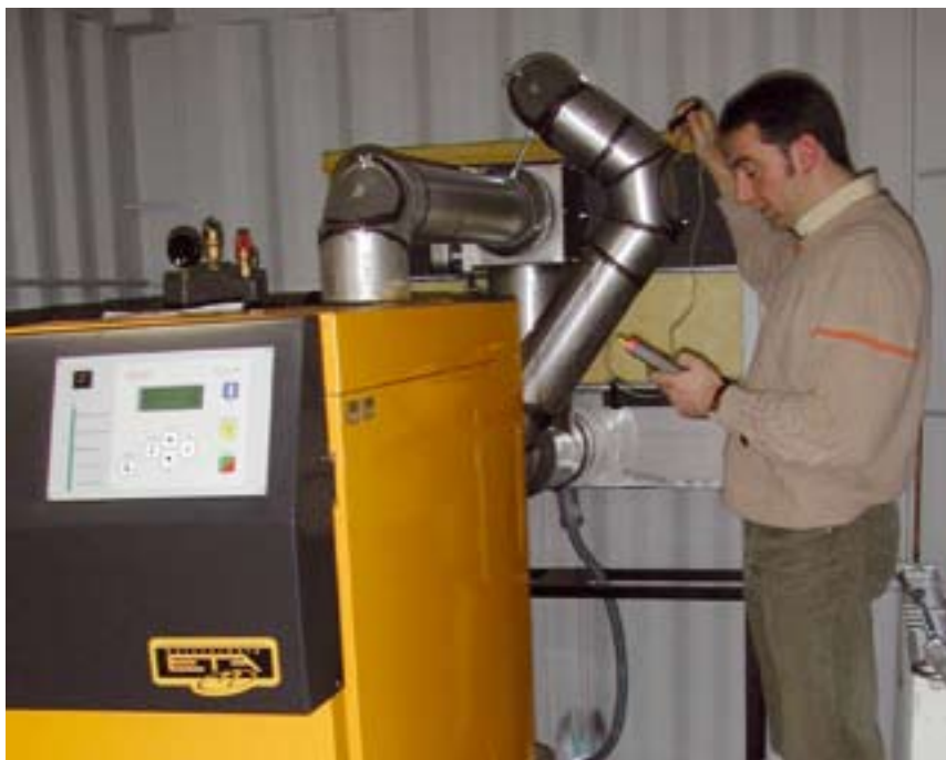
Messung der Abgastemperatur an einer Bomat-Anlage für Holzhackschnitzelfeuerungen
