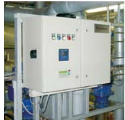
Außenansicht des Schaltschranks
