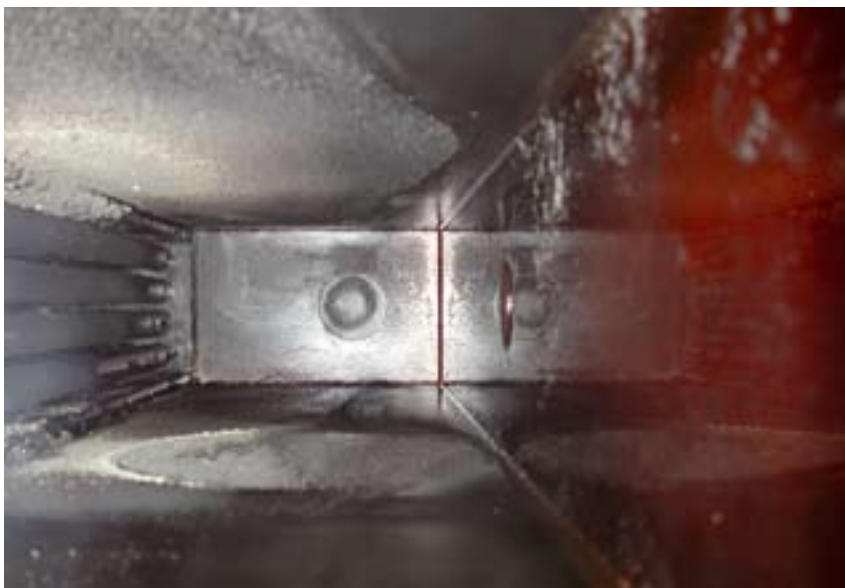
Blick auf die keramischen Wärmetauscher im Abgasschacht
