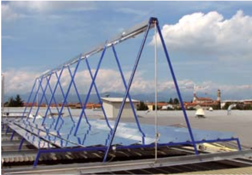
Mit der Wärme des Kollektors wird eine Ammoniak-Wasser-Absorptionskältemaschine betrieben.
